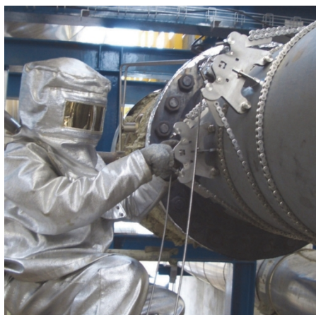
"Uvedení do provozu za tepla" v pravém slova smyslu - při teplotách stěn potrubí 400 °C.
